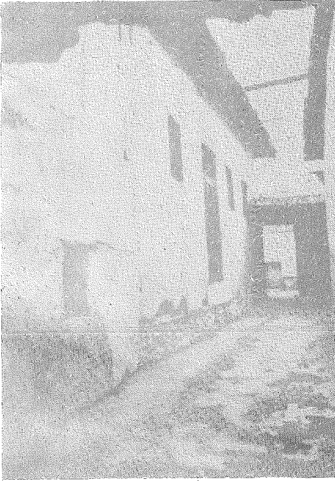
Resim 9 - İçten 15 no. lu cümle kapısı, Semâhane batı duvarı pencereleri ve niyaz penceresi girintisi
